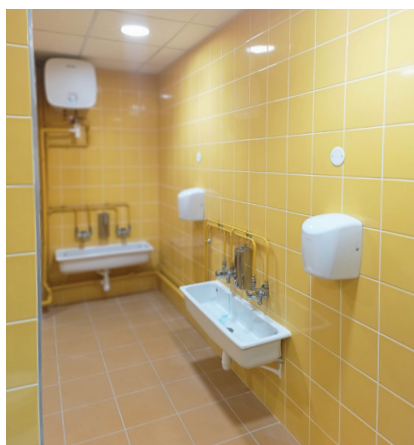
Des sanitaires, tous neufs en maternelle, dont l'aménagement d'un toilette adapté aux enfants à mobilité réduite.
